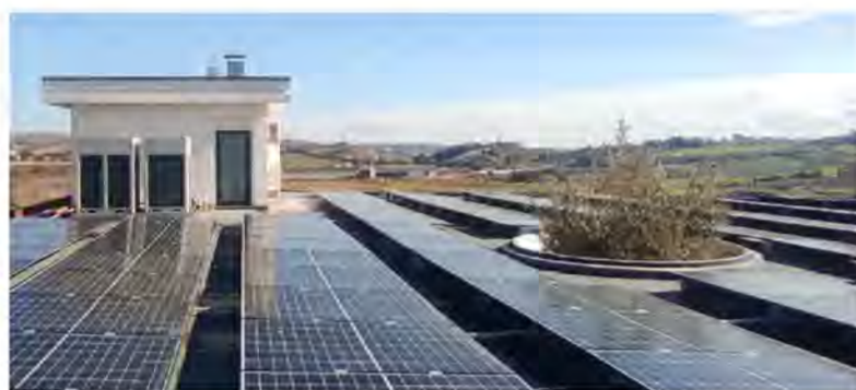
LA QUOTA di generazione elettrica del bilancio energetico dell'edificio ha annoverato anche quella relativa all'ampliamento dell'impianto fotovoltaico esistente sul lastrico solare, per una capacità totale di 107 kWp
