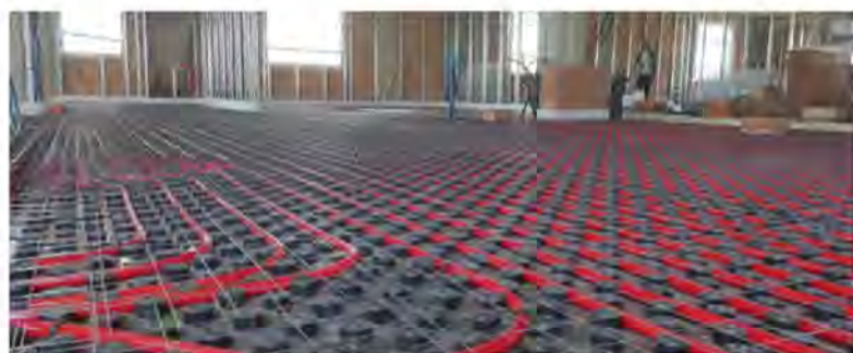
LA CLIMATIZZAZIONE degli ambienti, affidata al sistema VRF SMMS-u da 40 HP, presenta unità interne a colonna a integrazione di un sistema a pavimento radiante, e recuperatore di calore entalpico per il rinnovo dell'aria dei locali
