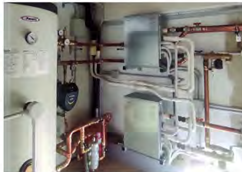
L'ACCUMULO acqua tecnica da 500 litri e i 2 moduli idronici da 5 HP ciascuno per la produzione di acqua calda fino a 50°C
